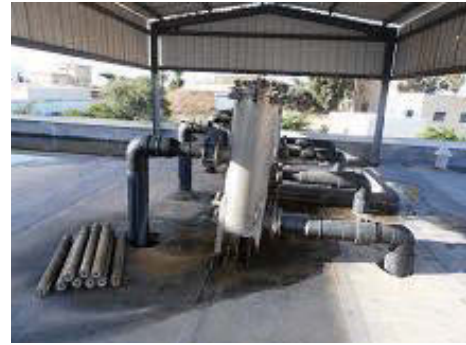
Microfiltres 2 (4 filtres sur le toit de la salle des pompes)
