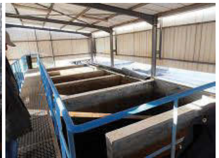
Bassin d'oxydation et filtres à sables
