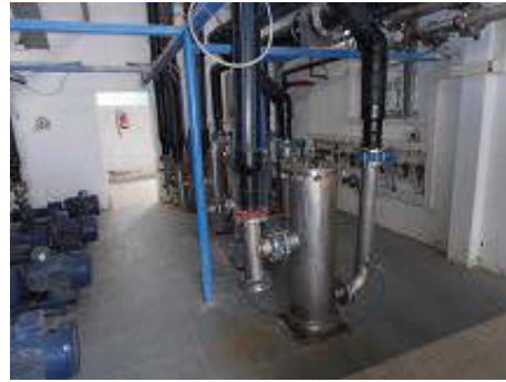
Microfiltres 1 (4 filtres dans la salle des pompes)
