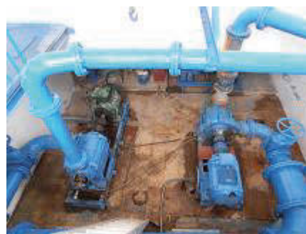
Station de reprise vers réservoir sur tour
