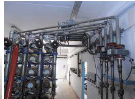
Bloc d'osmose inverse (L1 + L2 + L3 + L4)
